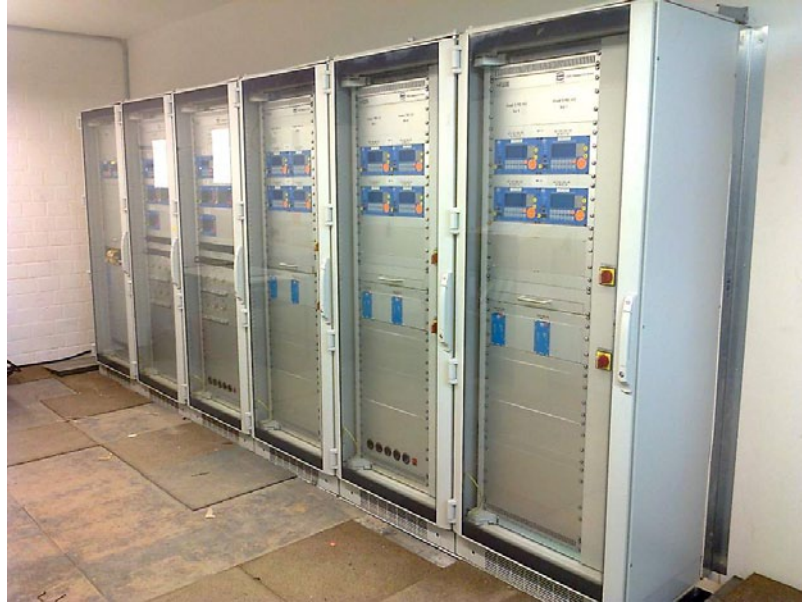
Bild 6. Schaltschränke der Firma RMG by Honeywell mit Messwertregistriergeräten des Typs MRG 2203, DSfG- und Profibusgateways, Ethernetrouter, sowie Flow Computer des Typs ERZ 2104 und Analysedatenrechner Typ GC9000 VC installiert im Elektroraum der Gasbetriebseinrichtungen [9].
